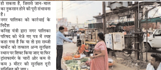
हो सकता है, जिससे जान-माल का नुकसान होने की पूरी संभावना है। नगर पालिका को कार्रवाई के निर्देश कनिष्ठ यंत्री द्वारा नगर पालिका परिषद को भेजे गए पत्र में स्पष्ट जा रहा है। दुकानदार ट्रांसफार्मर के बिल्कुल पास तक अपनी दुकानें लगा रहे हैं, जिससे खतरा और बढ़ गया है।
